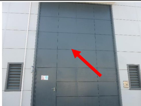
图6-2 110kV淹城变主变室外隔声门照片
