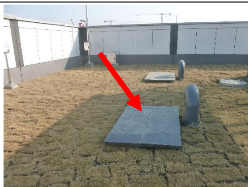
图6-4 110kV淹城变事故油池照片
