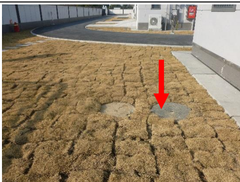
图6-3 110kV淹城变化粪池照片
