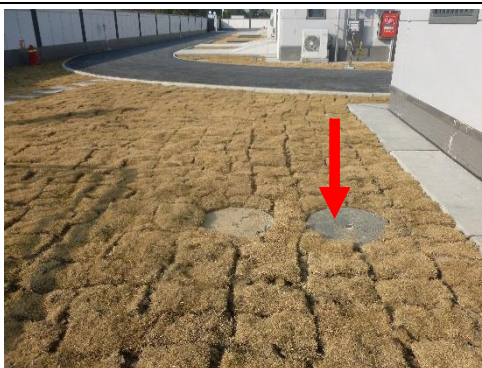
图 8-2 110kV 淹城变化粪池照片
