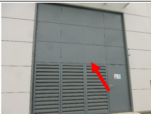
图6-2 110kV河东变主变室外隔声门照片
