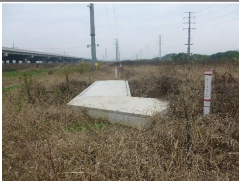
图6-1 本期线路采用电缆敷设照片
