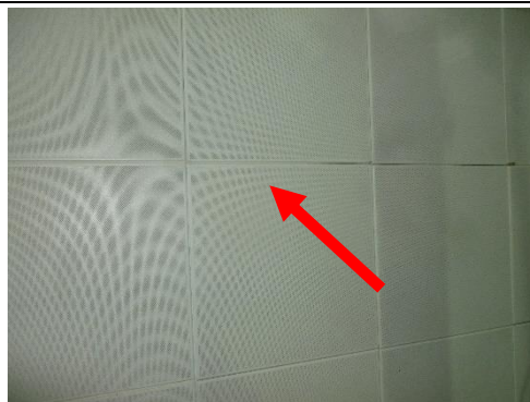
图6-2 110kV河东变主变室吸声墙照片
