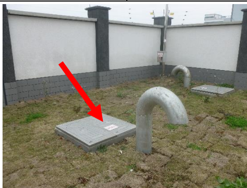
图6-4 110kV河东变事故油池照片
