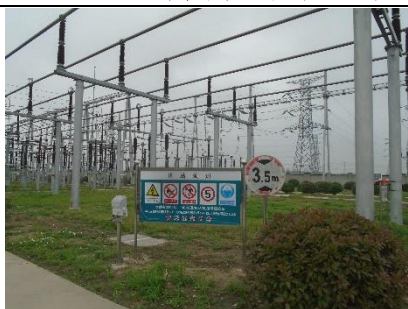
220kV 东鲍变站内绿化生态恢复示例
