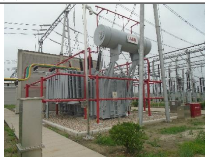
220kV 东鲍变站内绿化生态恢复示例
