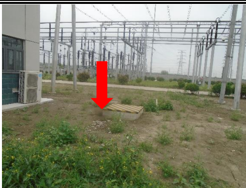
220kV 东鲍变事故油池
