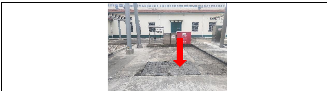
110kV 张甸变事故油池
