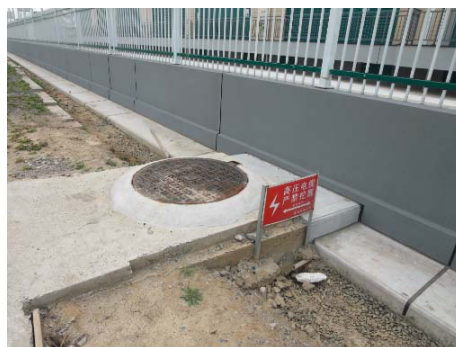
图 6-2 110kV 南江变电缆线路警示标志
